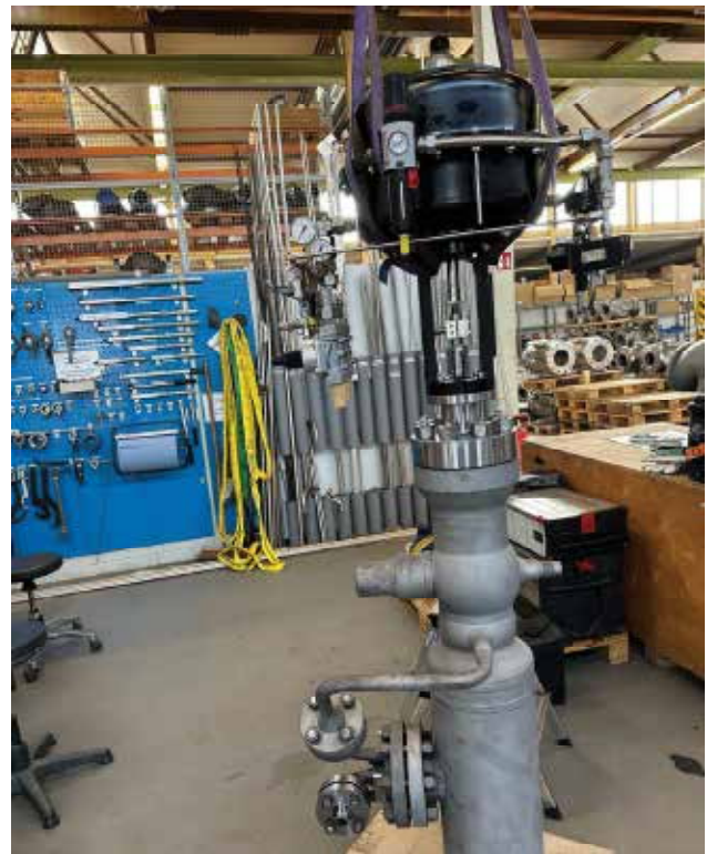
Das Bild zeigt eine Prozessdampf-Umformstation.
