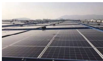
Dach mit Solarzellen.
