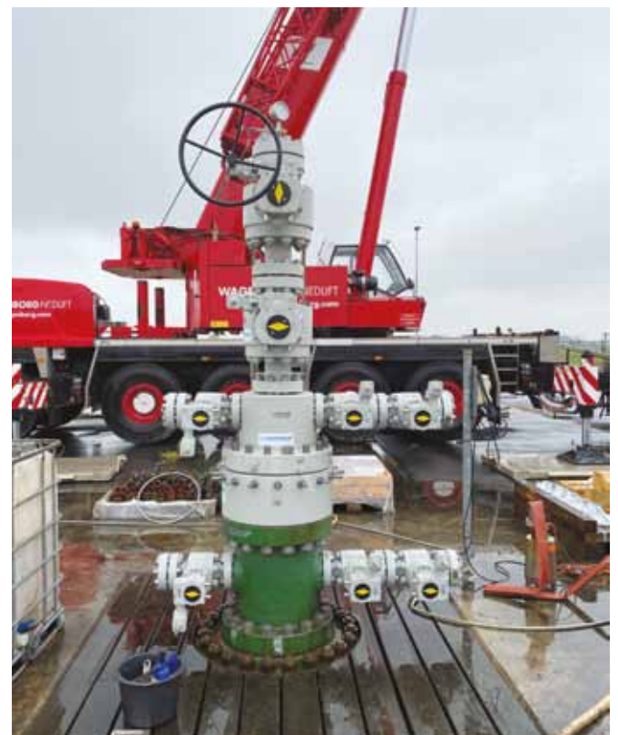
Erster Hartmann H 2 Wellhead für die großvolumige Speicherung von Wasserstoff in niederländischen Kavernen.
